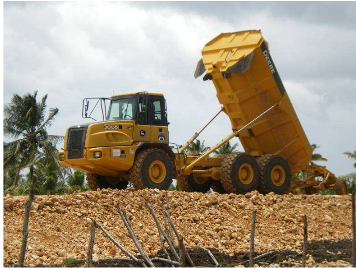
Camión depositando agregado de roca que se extrae de la explotación minera de la caliza.
